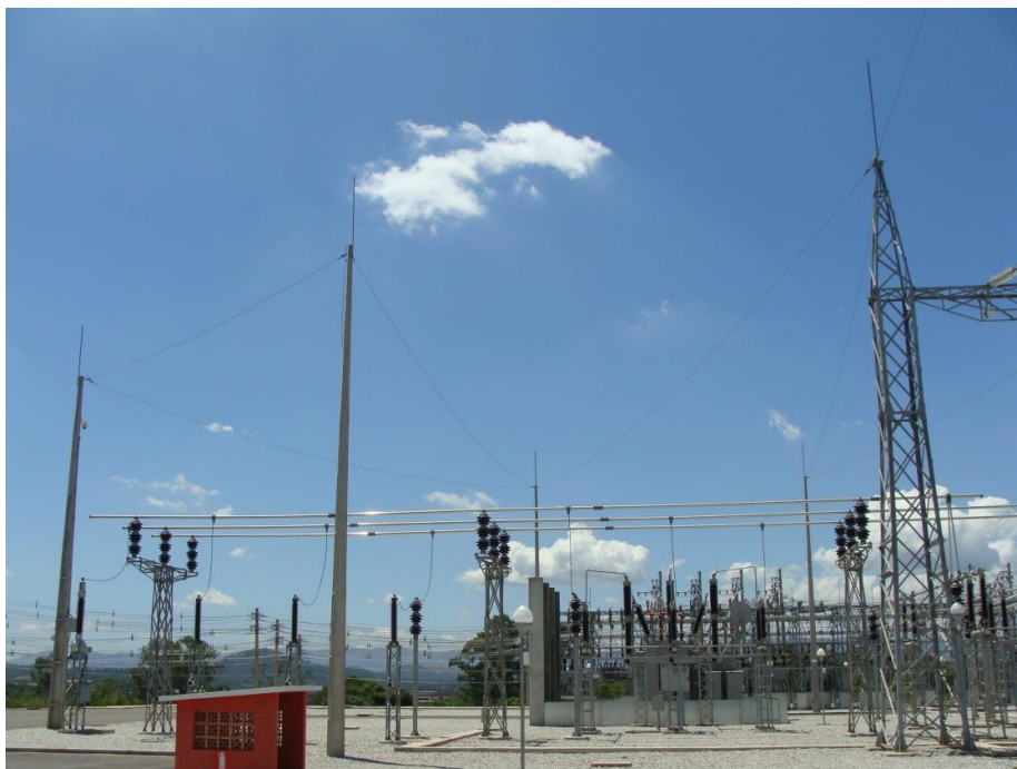
FIGURA 4 – Foto da SE construída. Sistema de blindagem existente.
